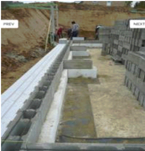
Figuur 41: Systeem van betonblokken en aangekoppelde isolatie, waarbij de wand wordt opgestort met beton (overgenomen van http://www.betondelalomme.be )
